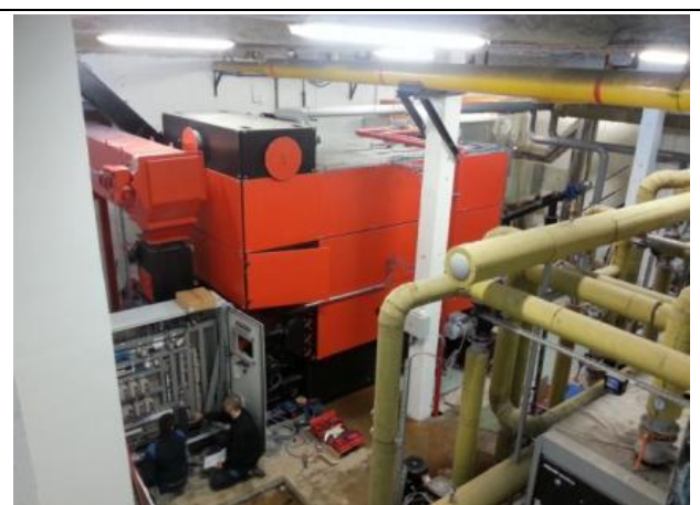
Exemple de chaufferie bois
