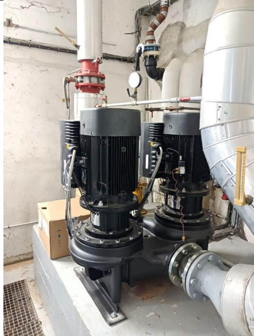
Pompes de circulation chauffage en sous-station
