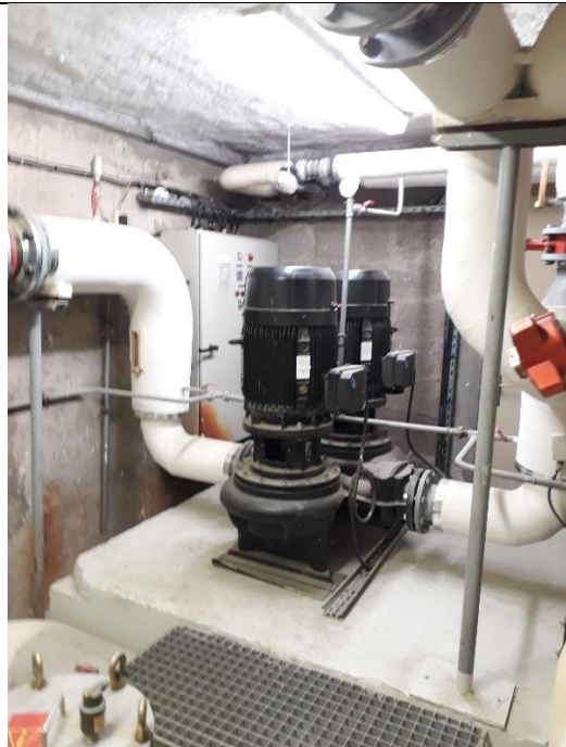
Pompes de circulation chauffage en sous-station
